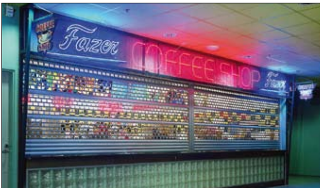
Murtosuojarullain, Hartwall Areena, Helsinki
